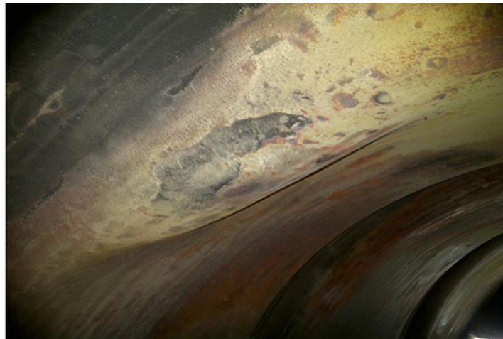
Gambar 3. Drum Boiler yang Mengalami Kerusakan
