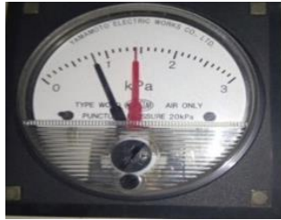
Gambar 2. Pressure Gauge yang digunakan
